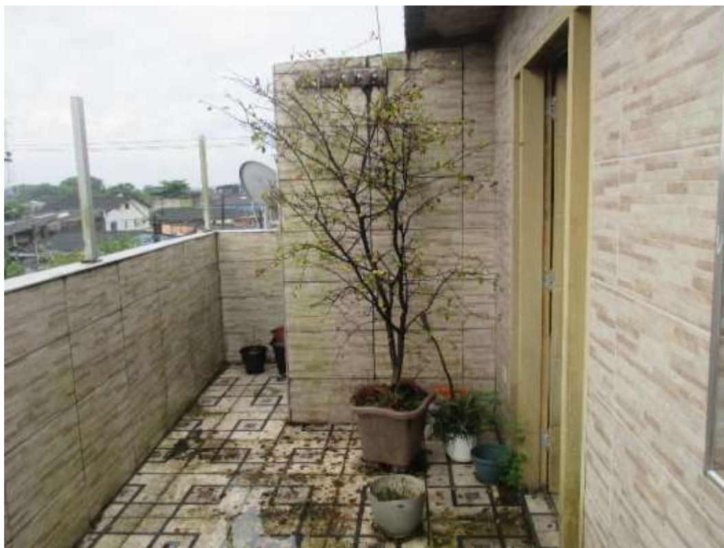
Terraço – na data da vistoria havia empoçamento de água.
