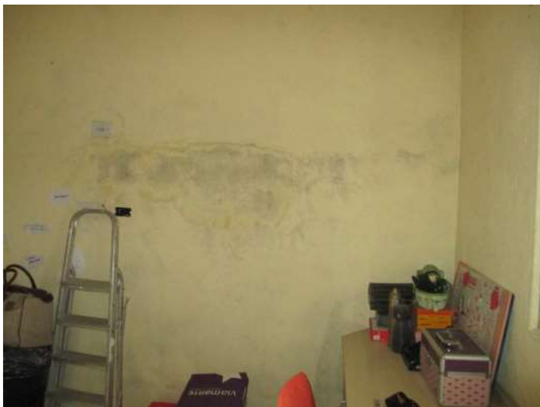
Alvenaria com pintura deteriorada por umidade.
