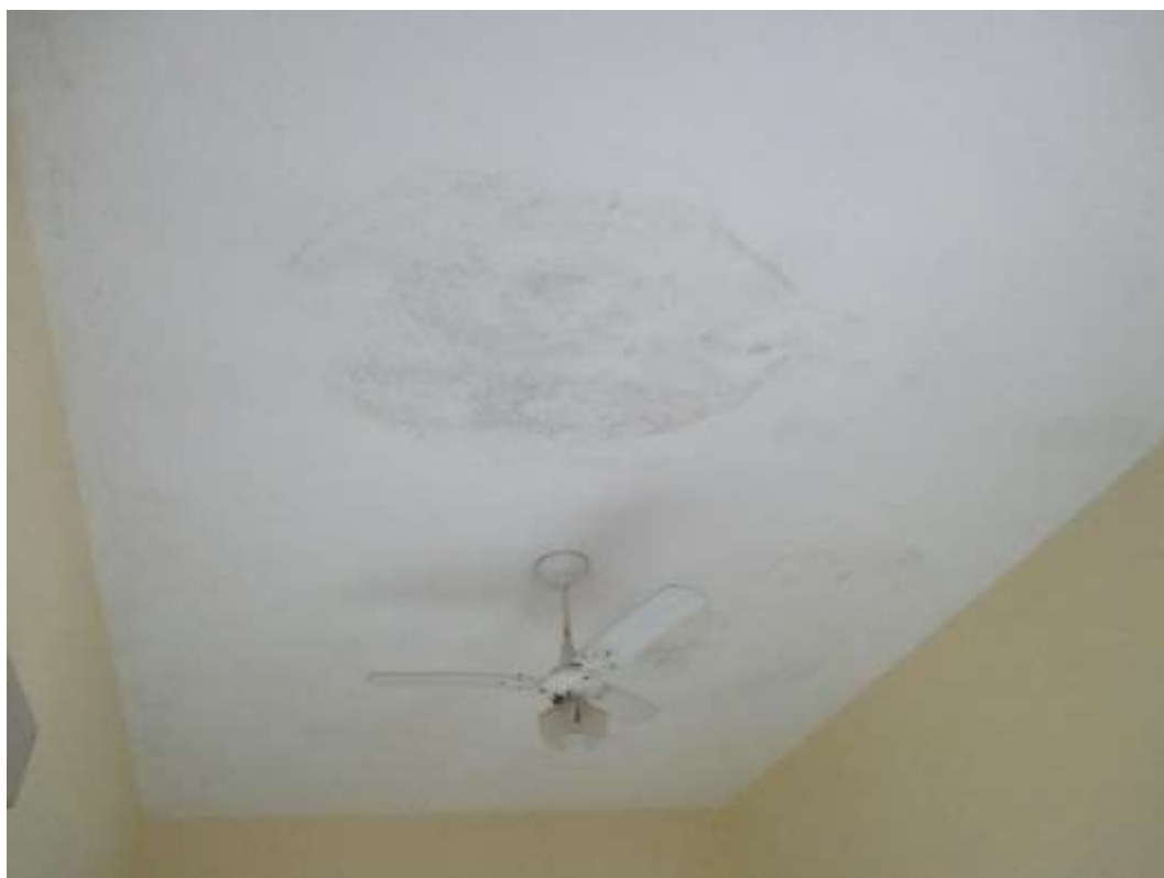
Laje de cobertura do dormitório com pintura deteriorada por umidade.
