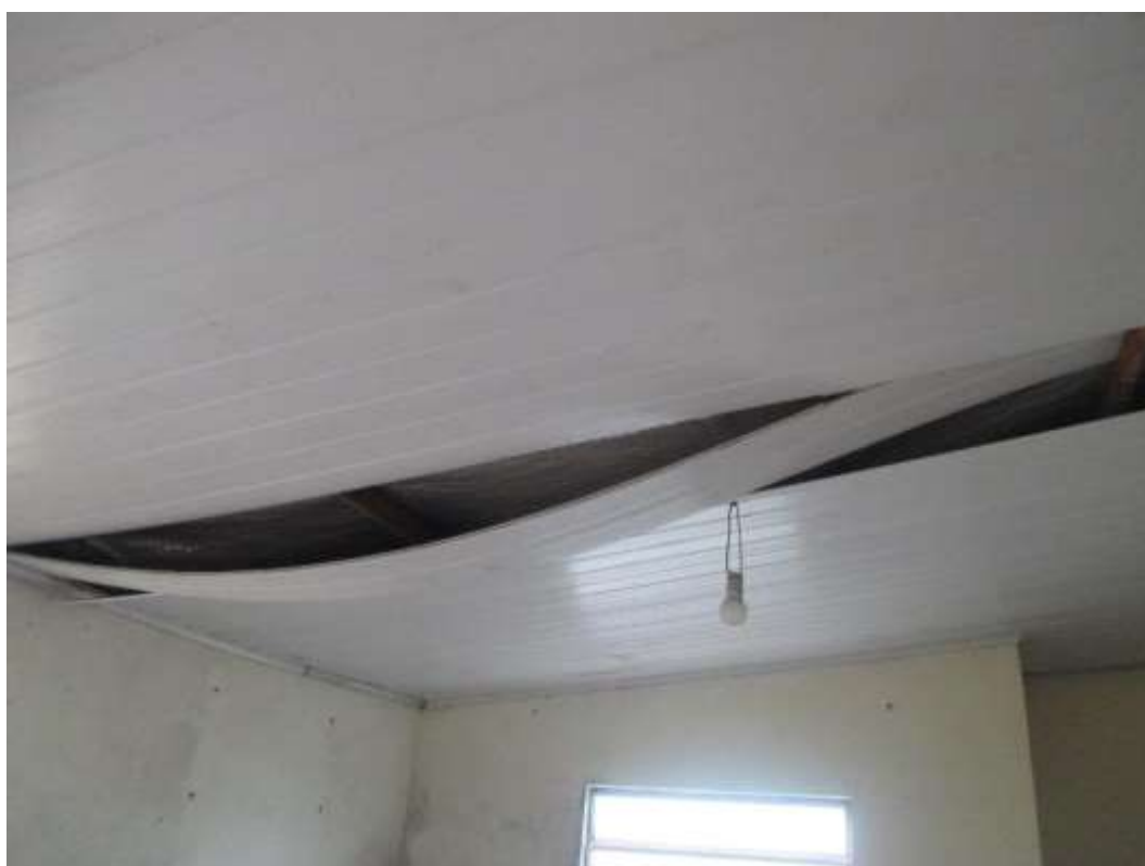
Lambri de pvc danificado.
