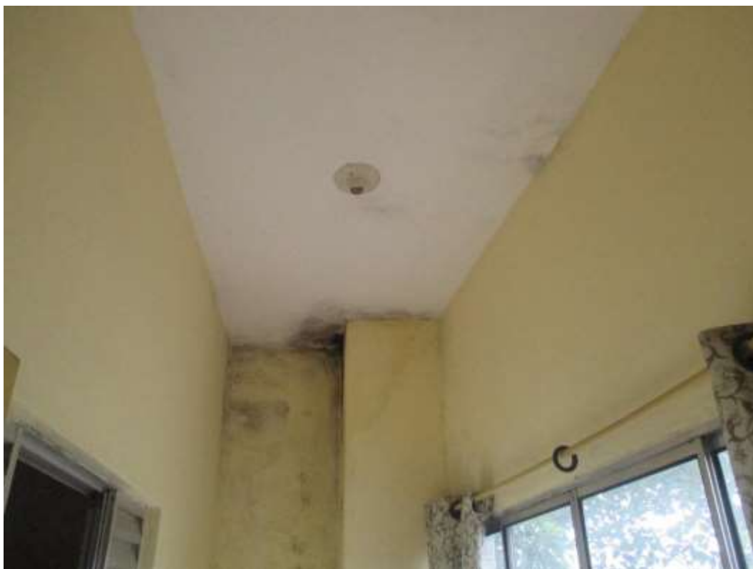
Laje de cobertura com sinais de infiltração.
