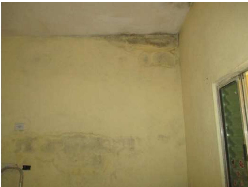
Mais sinais de infiltração de água pela alvenaria e laje.
