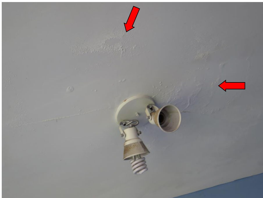
Detalhe da umidade na laje.
