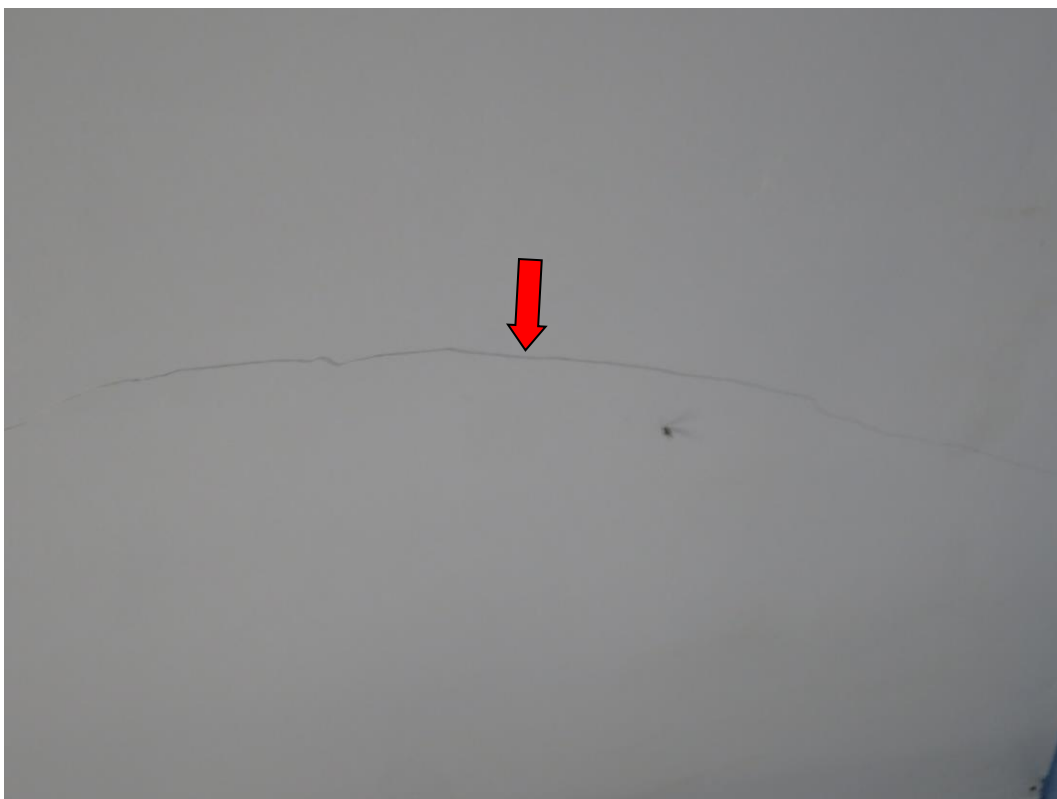
Detalhe de um dos pontos de fissura na garagem.
