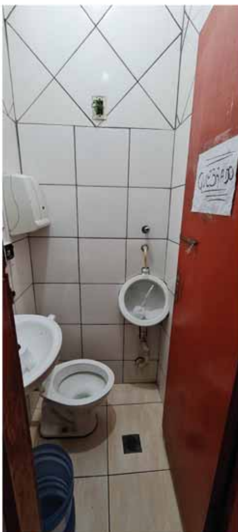
FOTO (12) Loja - banheiro 2 (quebrado).jpg
