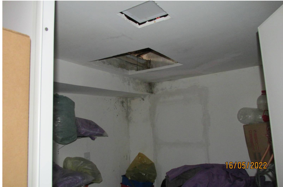
Foto 50) Vista do interior da dependência existente após a área constante na foto anterior. Observar áreas com indícios de infiltrações e necessidade de conservação.
